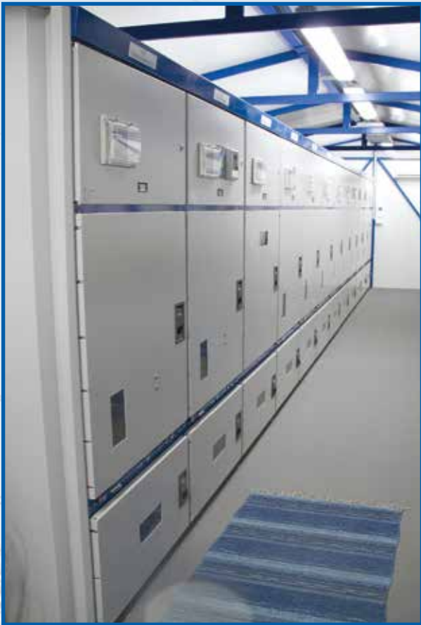
Ylitornion uusi sähköasema
